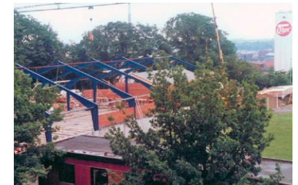
Et uue ud over byggepladsen i 1987, hvor hallen er ved at blive opført
